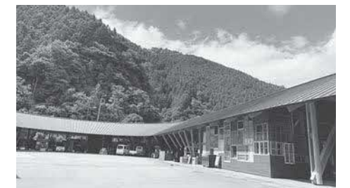
ゼロ・ウェイストセンターの雨樋状況
